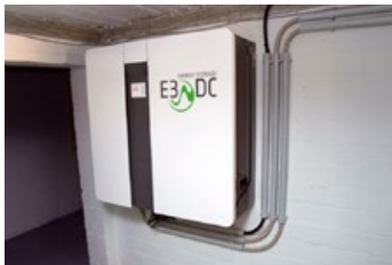
Kompaktpeicher einer PV-Anlage, Quelle: Merkblatt „Einsatz an stationären Lithium-Solarstromspeicher“, Herausgeber Bundesverband Solarwirtschaft e.V.
