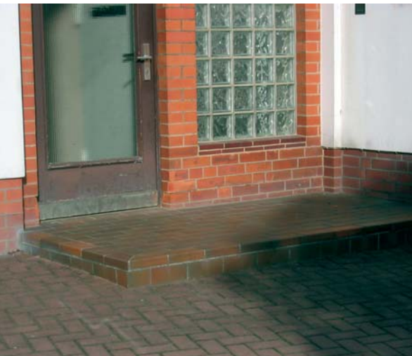
Podeste oder Stufen vor Eingängen sind immer eine Unfallgefahr. Rasengittersteine oder -matten sind aus Sicht der Prävention wegen der Rutschgefahr durch nassen Grasbewuchs keine Ideallösung.
