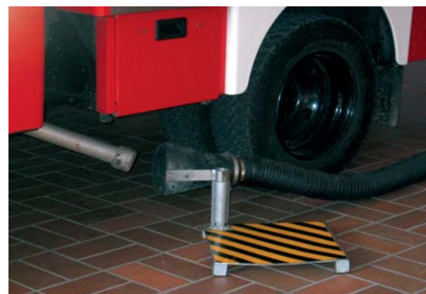
Minimallösung: stationäre Abgasabsaugung
