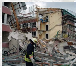
Einsturz eines Gebäudes durch unsachgemäße Bauarbeiten
