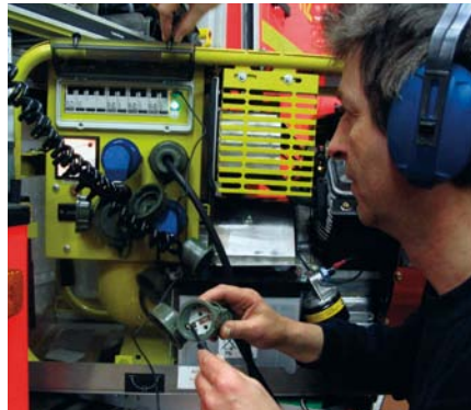
Überprüfung der Schutzmaßnahme eines tragbaren Stromerzeugers
