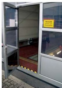
Warnung am Zugang vor der dahinter liegenden Arbeitsöffnung der Grube – das Warnzeichen fehlt.
