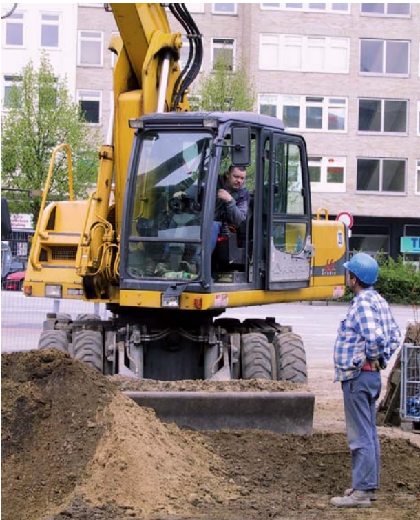
Der herangeführte Bagger kann gefährliche Erschütterungen verursachen.
