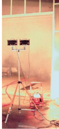
Einsatzstellenbeleuchtung durch Halogen-Flutlichtstrahler auf Teleskop-Dreibeinstativ
