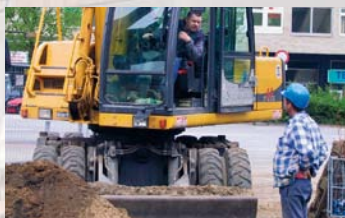
Ggf. Fachpersonal und Erdbau- maschinen hinzuziehen
