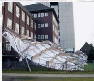
Gerüstumsturz durch Sturmeinwirkung
