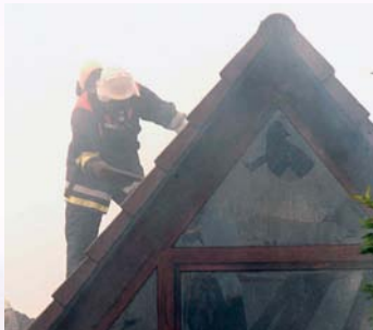
Absturzgefahr! Brandbekämpfung auf dem Steildach
