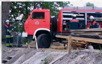
An Kanten von Baugruben und Gräben nicht dichter als 2 m heran- fahren (Schutzstreifen).
