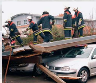
Einsturz durch Überlastung der Carport-Konstruktion
