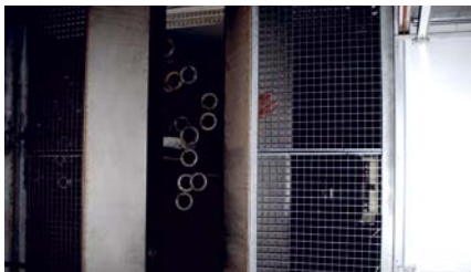
Schutzdach im Turm mit Betriebsdurchlass für die Schläuche (von unten in den Turm hinein fotografiert)
